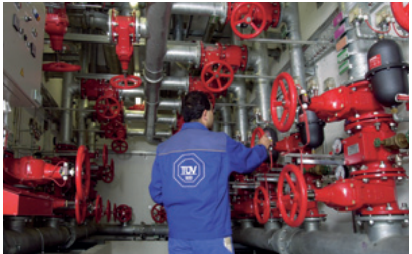
Bild 1: Der gebäudetechnische Brandschutz wird immer komplexer – damit erhöhen sich die Anforderungen an die Planung und Betriebssicherheit der Anlagen
