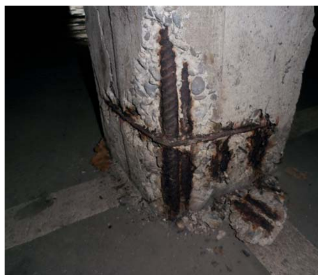
Abb. 1: Abplatzungen der Betondeckung und freiliegende Bewehrung im Sockelbereich einer Tiefgaragenstütze (Korrosion durch Karbonatisierung)
