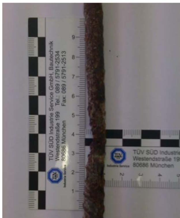
Abb. 2 a/b: Freigelegter Bewehrungsstahl mit Anzeichen von Lochfraßkorrosion (Querschnitt gemindert durch Chlorid-induzierte Korrosion)
